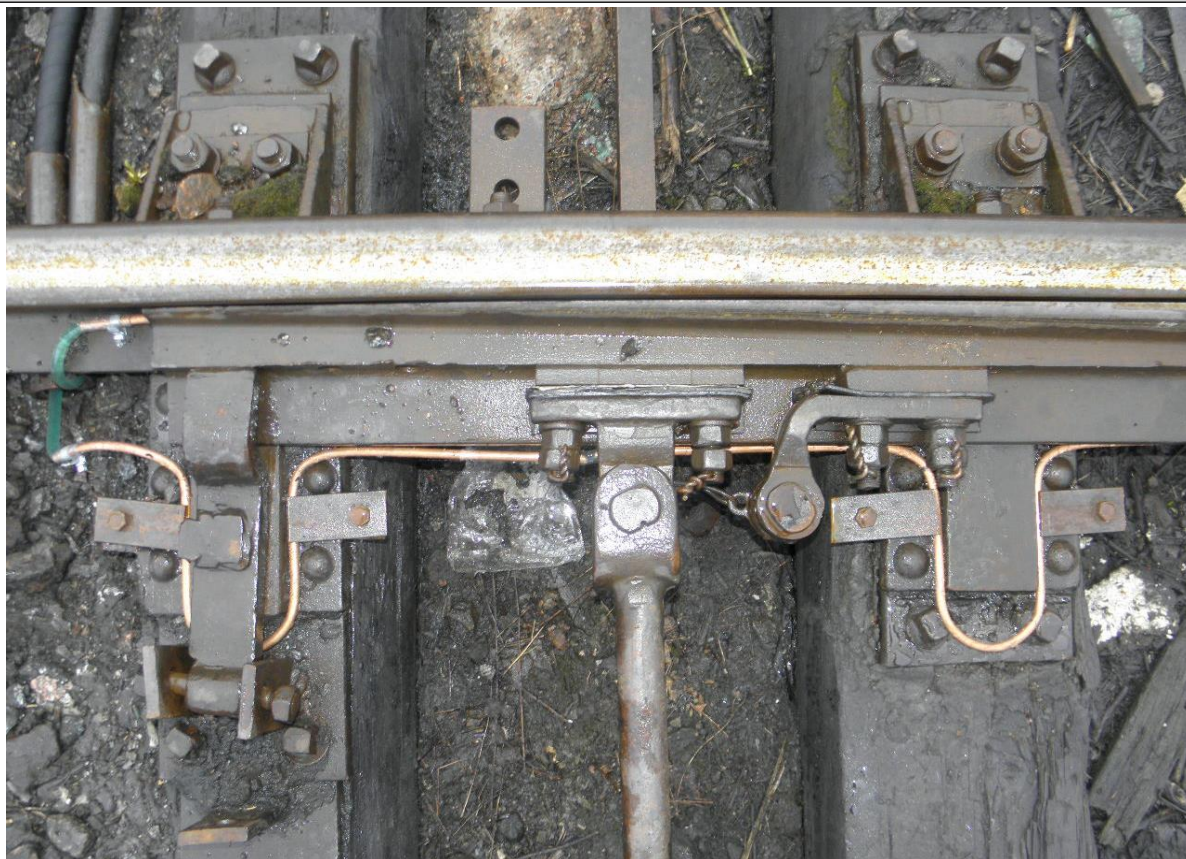
Рис. 5. Расположение фрагмента участка трубопровода, осуществляющего непосредственный нагрев стрелочного перевода опытного образца установки
